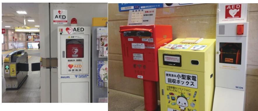
図5.7 AEDの設置状況事例（厚生労働省、2015）
